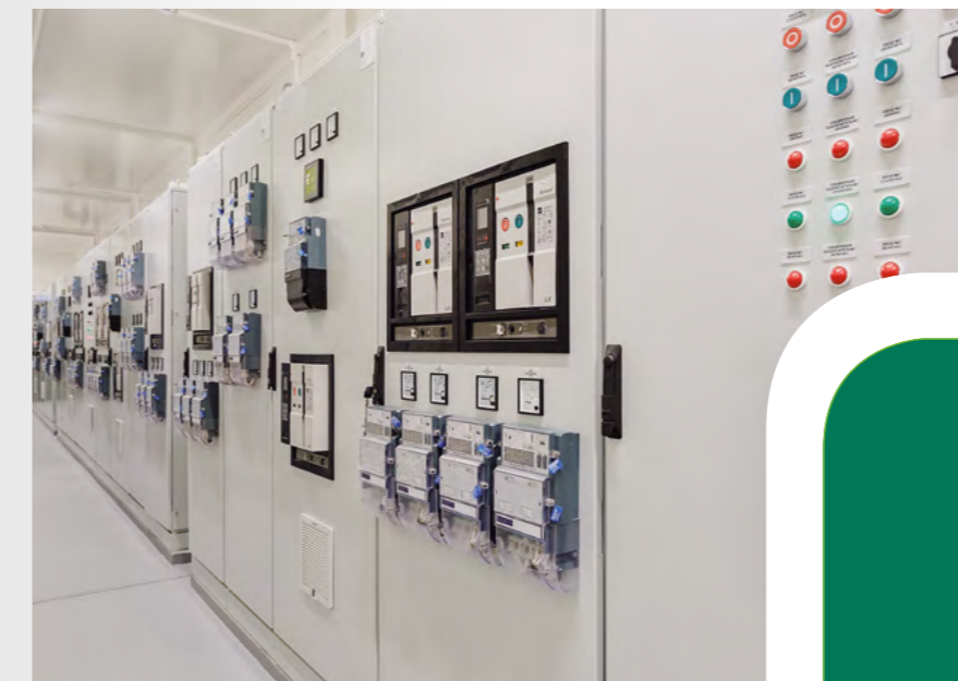
Трехсекционное распределительное устройство 0,4 кВ с НКВ-ТЭС
