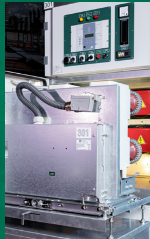
Рис. 3.20. Выкатной элемент в ремонтном положении
