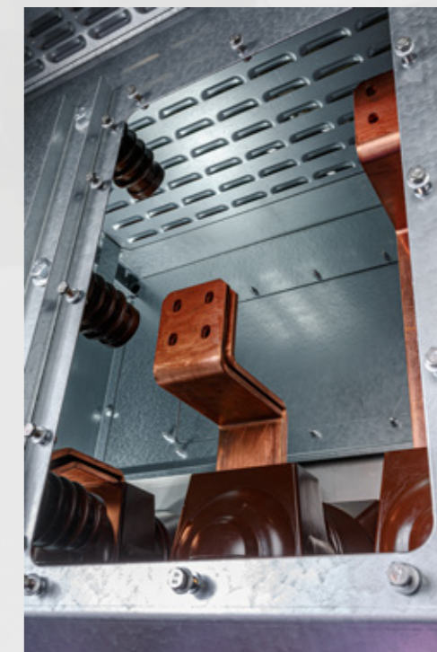
Рис. 3.12. Отсек сборных шин
