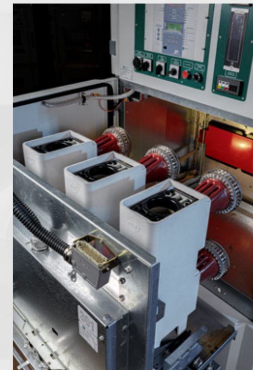
Рис. 3.3. Отсек выкатного элемента
